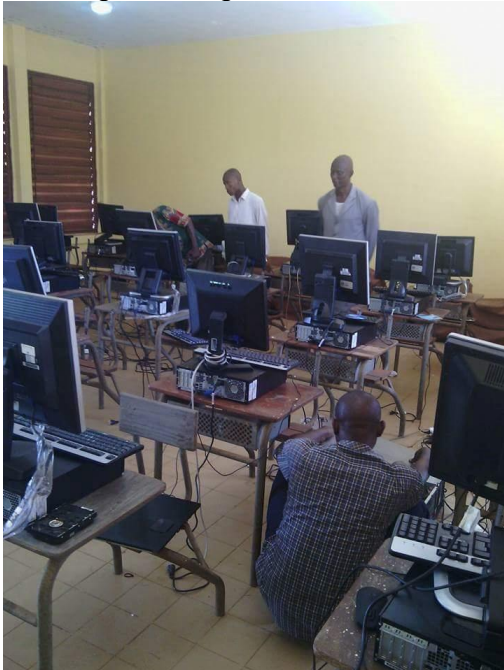
Installation der PCs aus dem Container
