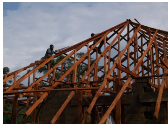
Dach der Krankenstation in Assaka
